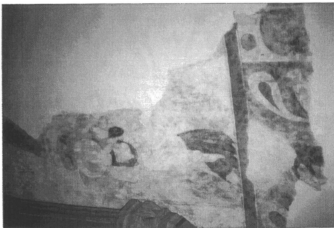
60 Mur Nord, registre inférieur, deuxième travée. Fragment d'enduit médiéval avec peinture figurative après la restauration en 1995.
