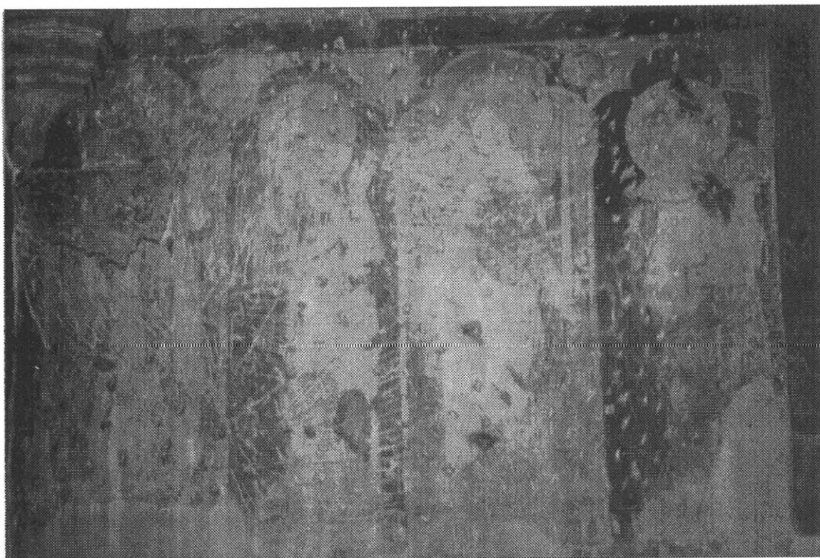
44 Choeur, paroi Sud, registre inférieur à gauche de la première fenêtre. Etat avant la restauration en 1992.
