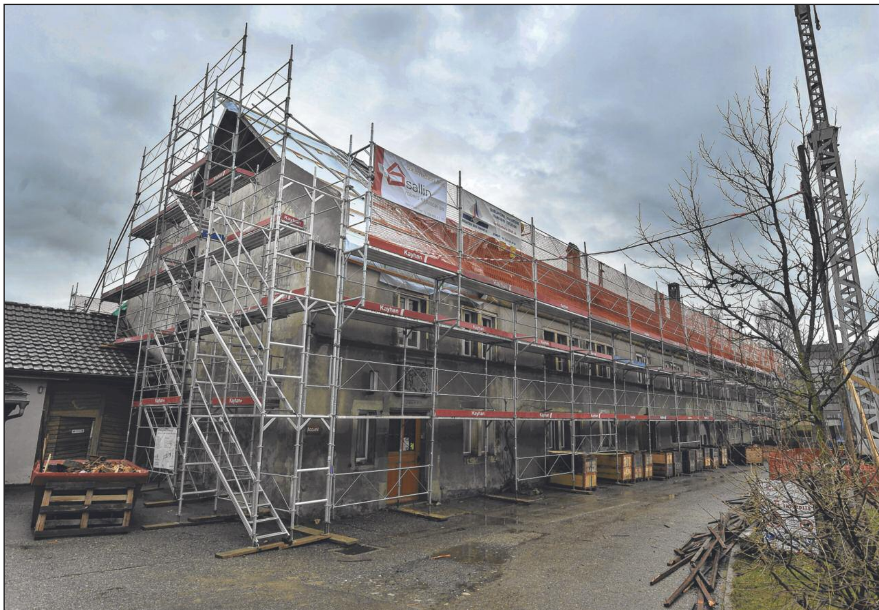
Les travaux doivent durer quatre mois. Six ou sept ferblantiers-couvreurs et charpentiers vont s'activer sur la toiture de l'hôtellerie.
